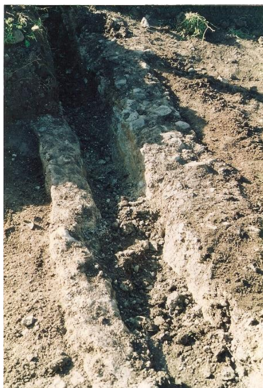
Fig. 11: MONASTIR - Loc. Santa Lucia. Dettaglio della condotta ipogea (da NE) (foto d'archivio).
