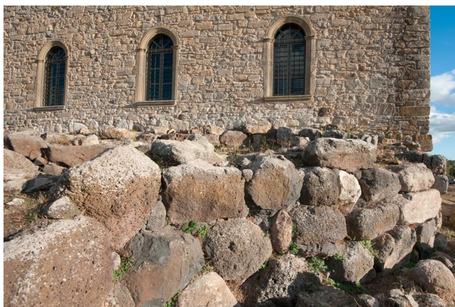
Fig. 2: La sovrapposizione evidente delle mura del palazzo su quelle più antiche del palazzo. In primo piano l'opera muraria della cortina ovest e della torre nord-ovest.
