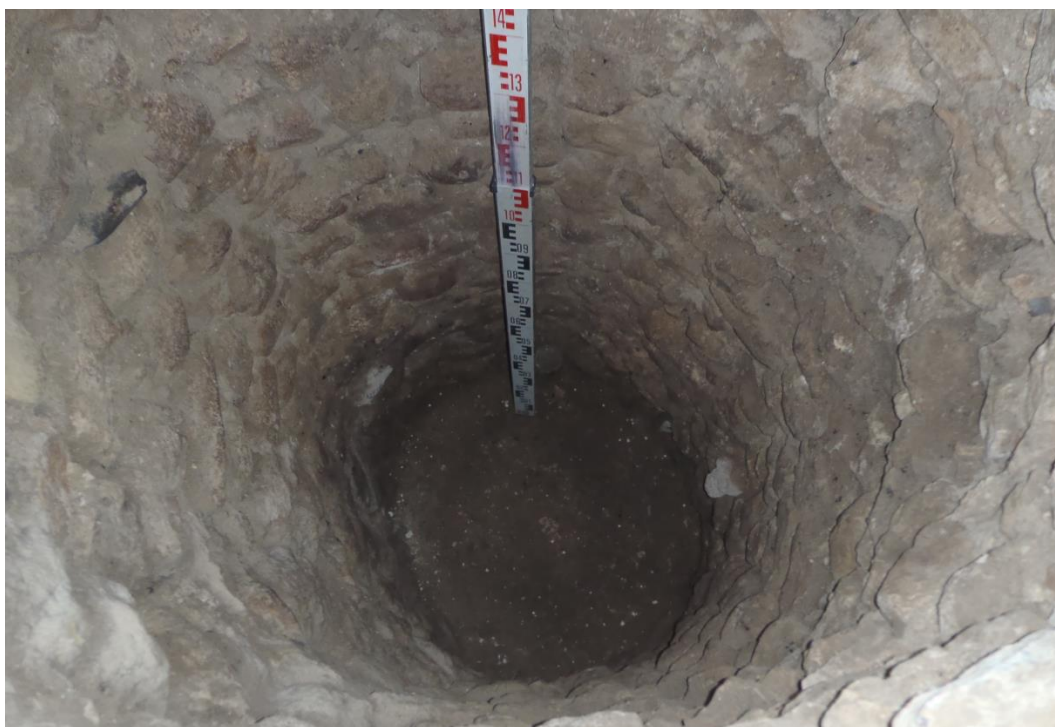
Fig. 24. Pozzo individuato nella seconda cappella destra.
