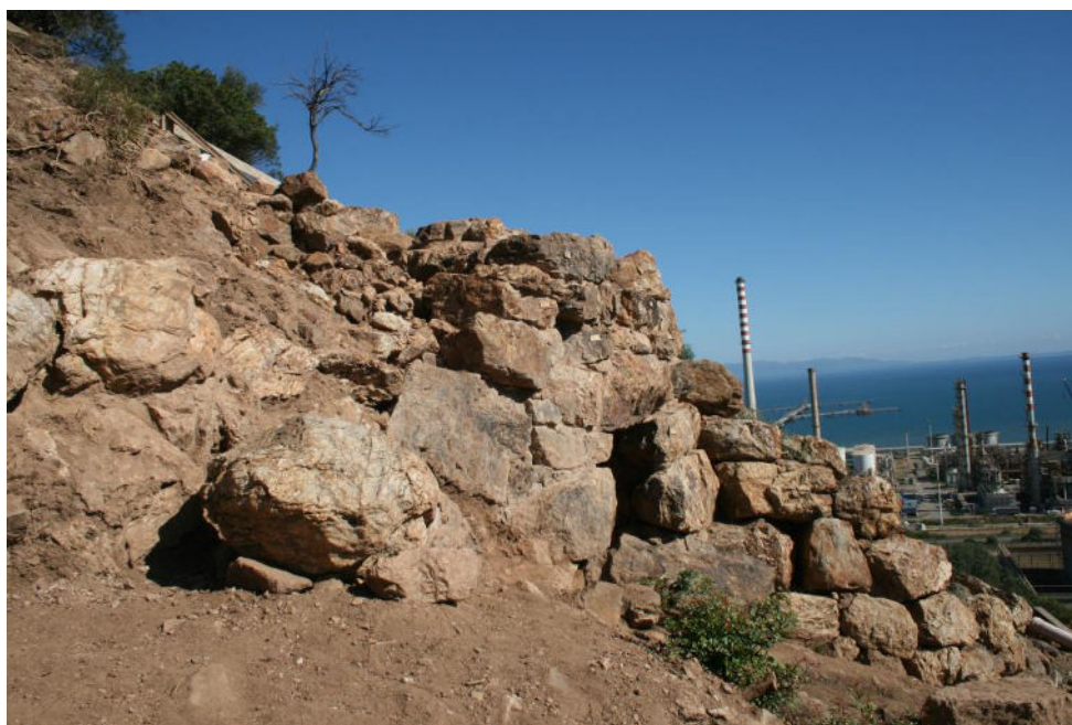
Fig. 1: SARROCH - Loc. Nuraghe Antigori. La cortina Sud con l'ingresso e la torre H al termine dei lavori di consolidamento.
