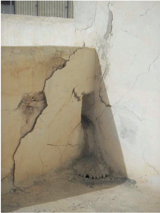
Fig. 40. Fissures au niveau de l'acrotère
