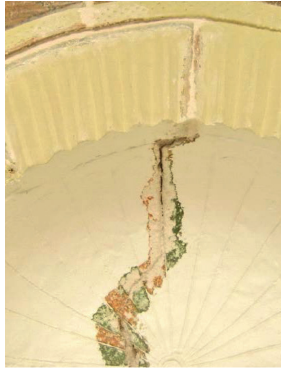
Fig. 41. Fissures au niveau du Mihrab extérieur et la descente d'eau pluviale.
