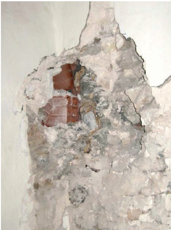
Fig. 15. Des fissures obliques au niveau de la paroi interne de la salle de prière.
