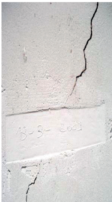
Fig. 23. Témoins des fissures de la ghorfa au rez-de-chaussée.
