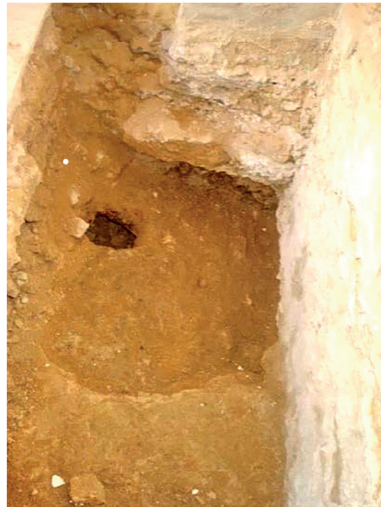
Fig. 16. Témoin de l'infiltration d'eau sous le regard.
