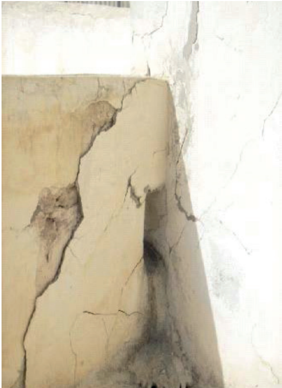
Fig. 19. Fracture au niveau de l'acrotère et du plancher de terrasse.
