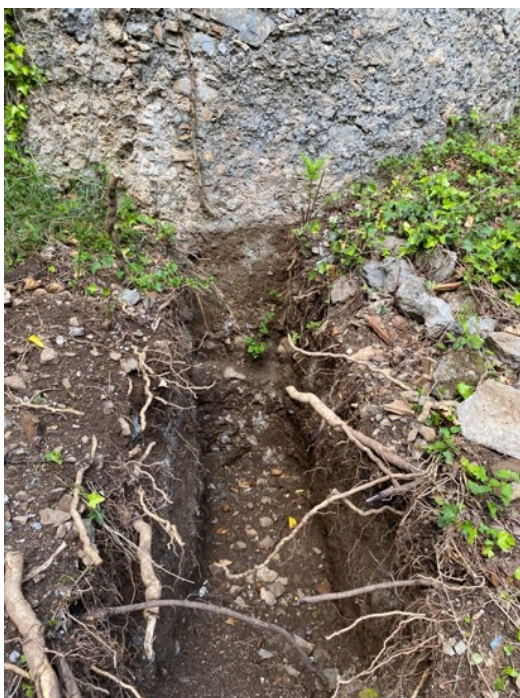
Fig. 5. Fiumefreddo Bruzio (CS), abbazia di Santa Maria di Fontelaurato, fondazioni dell'absidiola destra (foto dell'A.).
