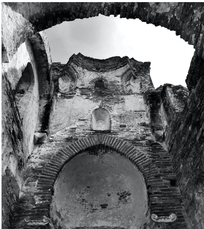
Fig. 15. Staiti (RC), Santa Maria de' Tridetti, frammenti del sistema di sostegno della cupola (foto dell'A.).
